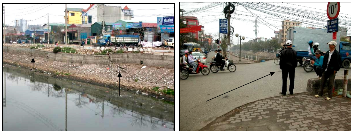
Figure 3.13 : Influence de la subsidence sur les ouvrages d'art, à gauche un mur de canal et à droite un pont en « altitude » (Photographie A.NOEL, 13-03-2008)
