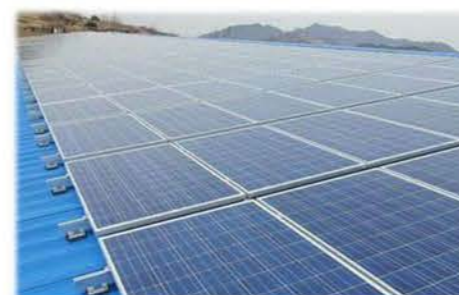
太阳能集热板结合屋面造型安装
