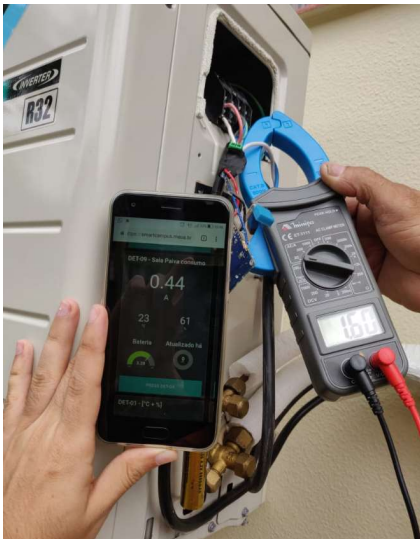
FIGURA 21 – DIVERGÊNCIA NA MEDIÇÃO DA CORRENTE DO EQUIPAMENTO
