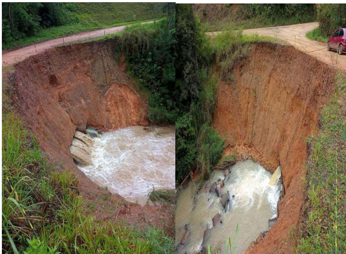
Imagem 06: Desmoronamento no Bueirão na localidade de Roncador.
