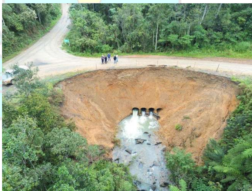
Imagem 12: Necessidade de manutenção do Bueirão do Roncador.
