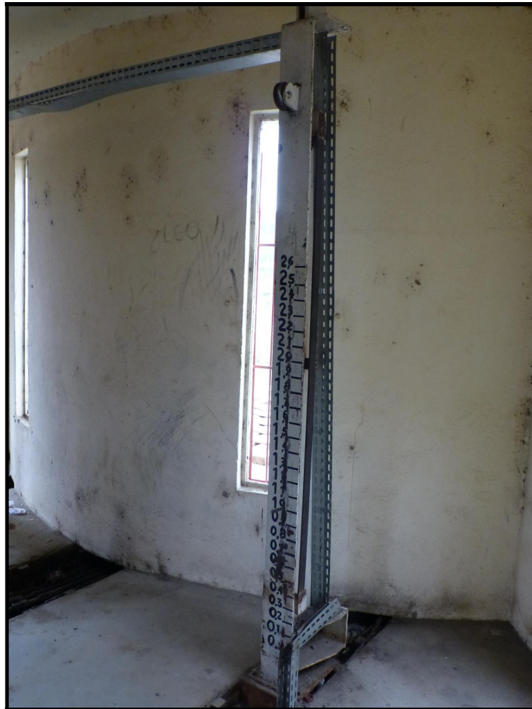
Foto 60 – Régua de Medição da Abertura da Comporta.
