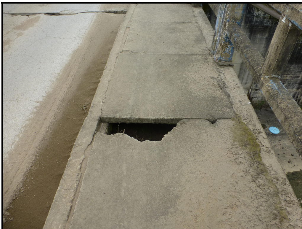
Foto 67 – Placa de concreto da calçada da ponte quebrada.
