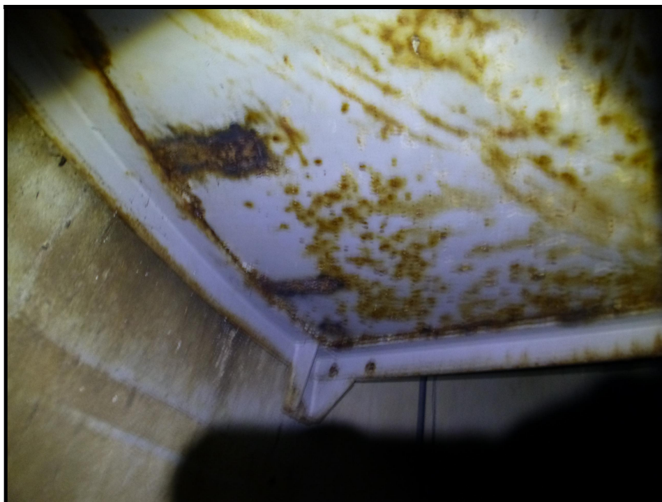
Foto 55 – Vista inferior do Patamar de Descanso da Escada Tipo Marinheiro do poço de acesso à Galeria das Comportas, com problemas avançados de corrosão.
