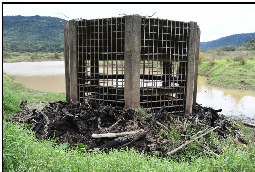
Foto 35 –Estrutura de emboque tipo tulipa (entrada do Túnel Externo ) com acúmulo de troncos e galhos na parte inferior.
