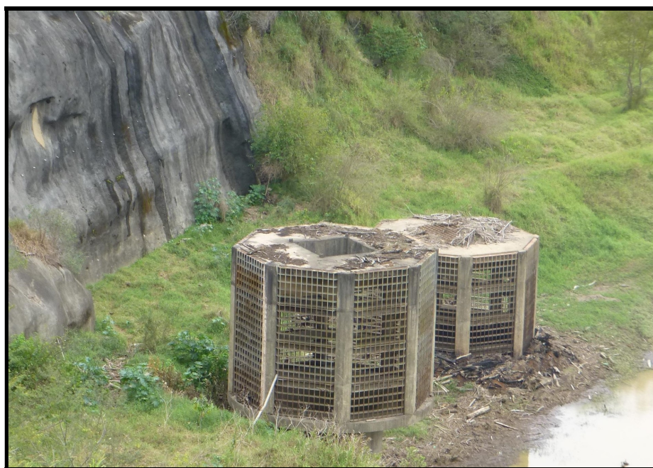
Foto 31 – Emboque Tipo Tulipa dos Túneis de Descarga.
