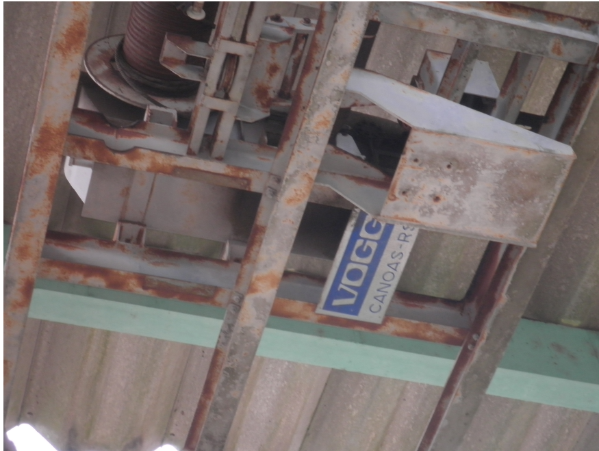
Fotos 57 – Ausência das roldanas, do gancho, cabo de aço e gancho da elevação.
