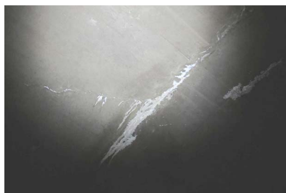
Foto 22 Túnel Interno – 4ª fissura contada de montante para jusante no trecho livre.
