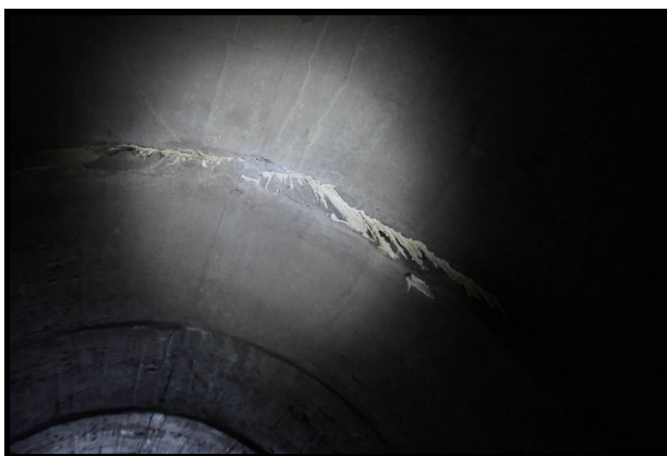
Foto 27 – Fissura com carbonatação no trecho livre do túnel externo.
