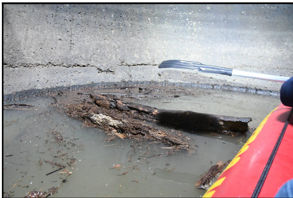
Foto 33 – Parte interna da Tulipa do Túnel esquerdo sem cavitação nem erosão mesmo com a entrada de troncos devido à ausência da grade superior. A trinca/fissura horizontal decorre de falhas na junta horizontal de concretagem.
