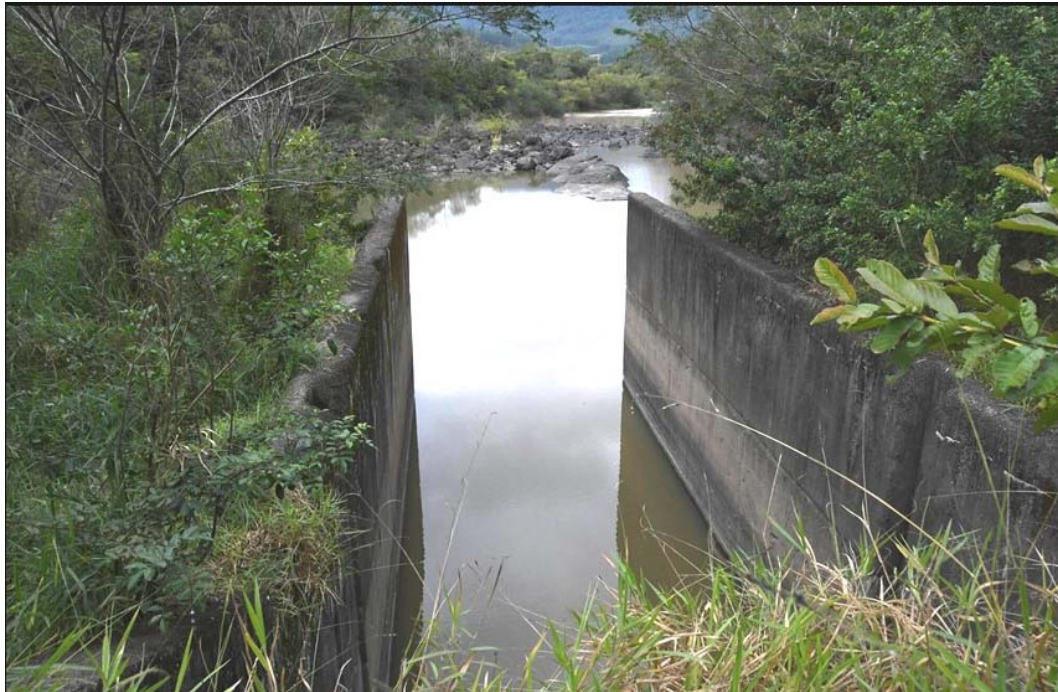
Foto 41 – Boca de saída do túnel interno, com excesso de vegetação do entorno.
