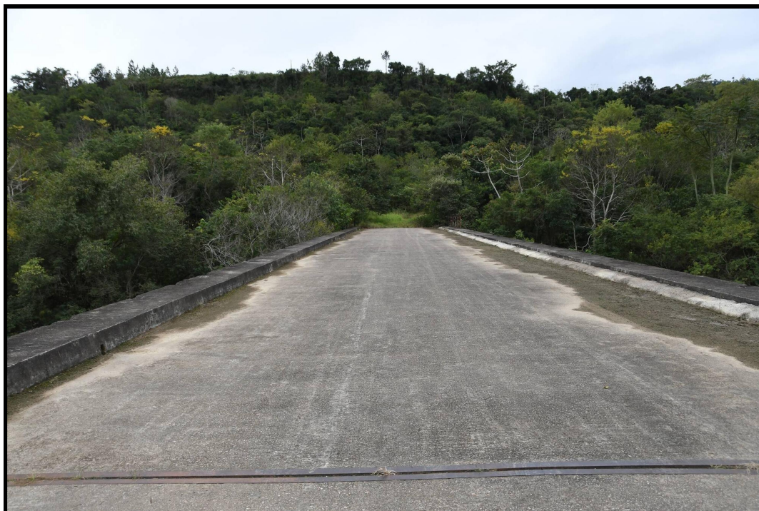
Foto 72 – Vista geral da ponte de jusante, com ausência de guarda corpo.
