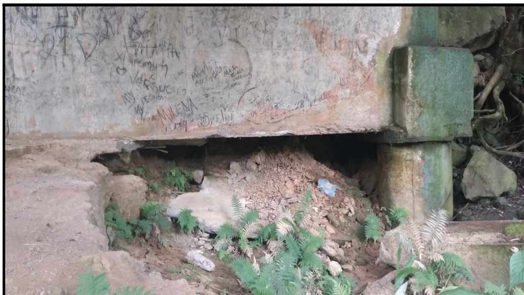
Foto 73 – Processo inicial de erosão sob os pilares da ponte que pode afetar o aterro da pista junto ao encontro esquerdo da ponte.
