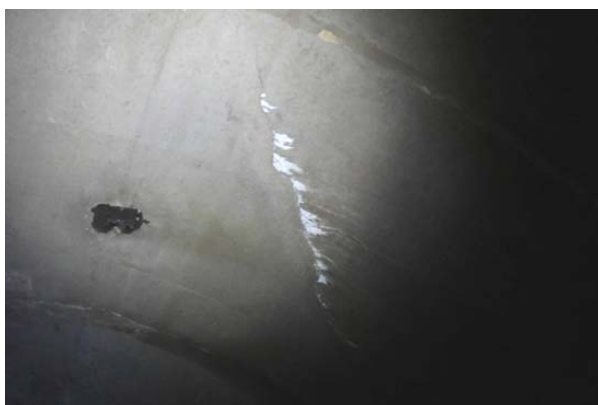
Foto 23 – Túnel Interno - 5ª fissura contada de montante para jusante no trecho livre.
