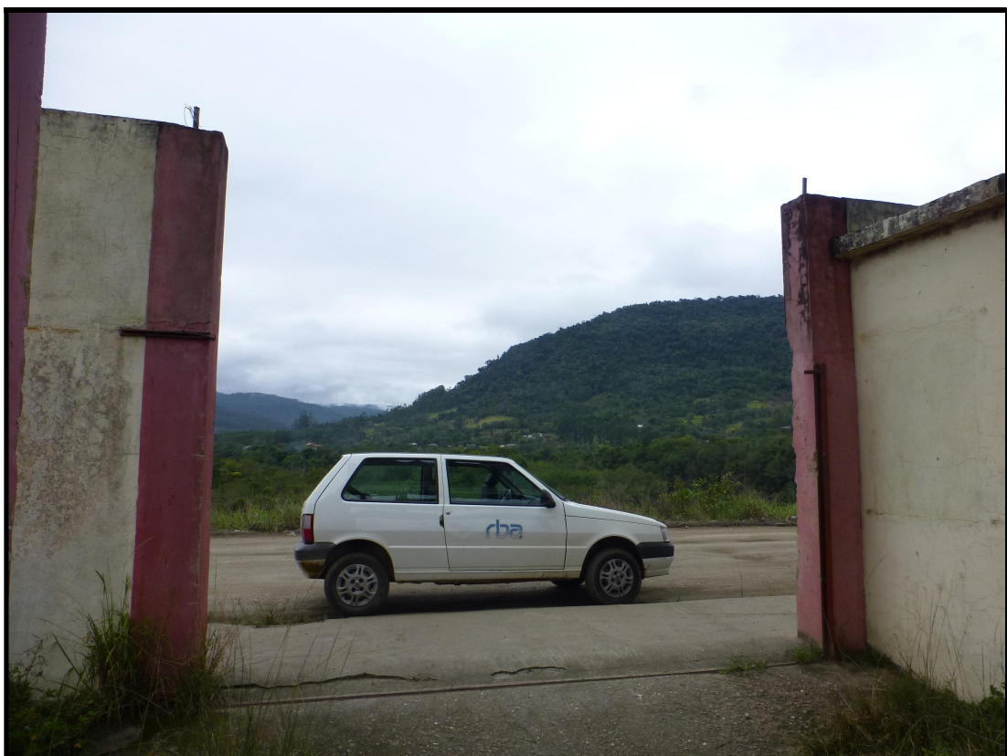
Foto 48 – Ausência de Portão da Plataforma de Operação das Comportas, devido às depredações ocorridas.
