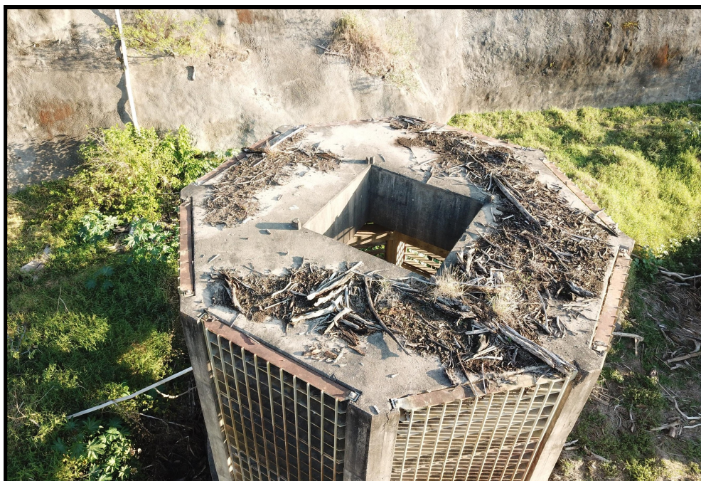
Foto 39 – Observa-se a Ausência da Grade da Laje Superior da Estrutura de Emboque Tipo Tulipa do Túnel Interno de Descarga
