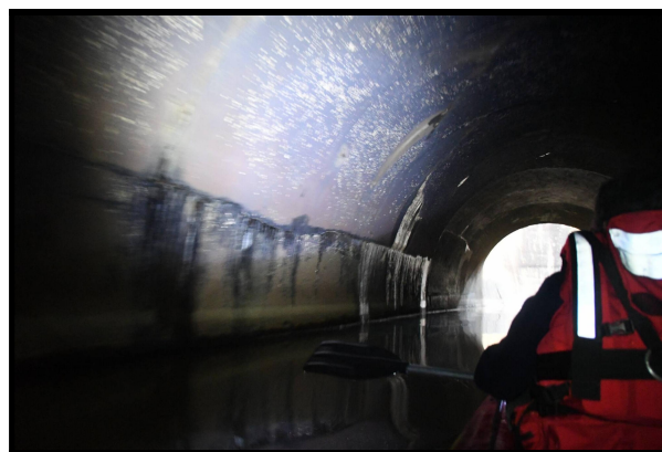
Foto 30 – Junta horizontal com percolação próximo à extremidade de jusante do Túnel Externo.
