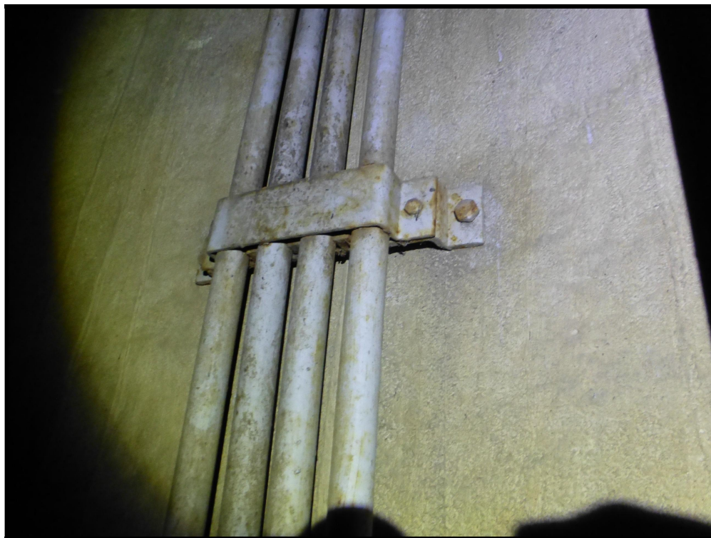
Foto 61 – Conduitos Metálicos de Óleo da Unidade Óleo-Hidráulica da Acionamento das Comportas em bom estado, a menos de manutenção e pintura.
