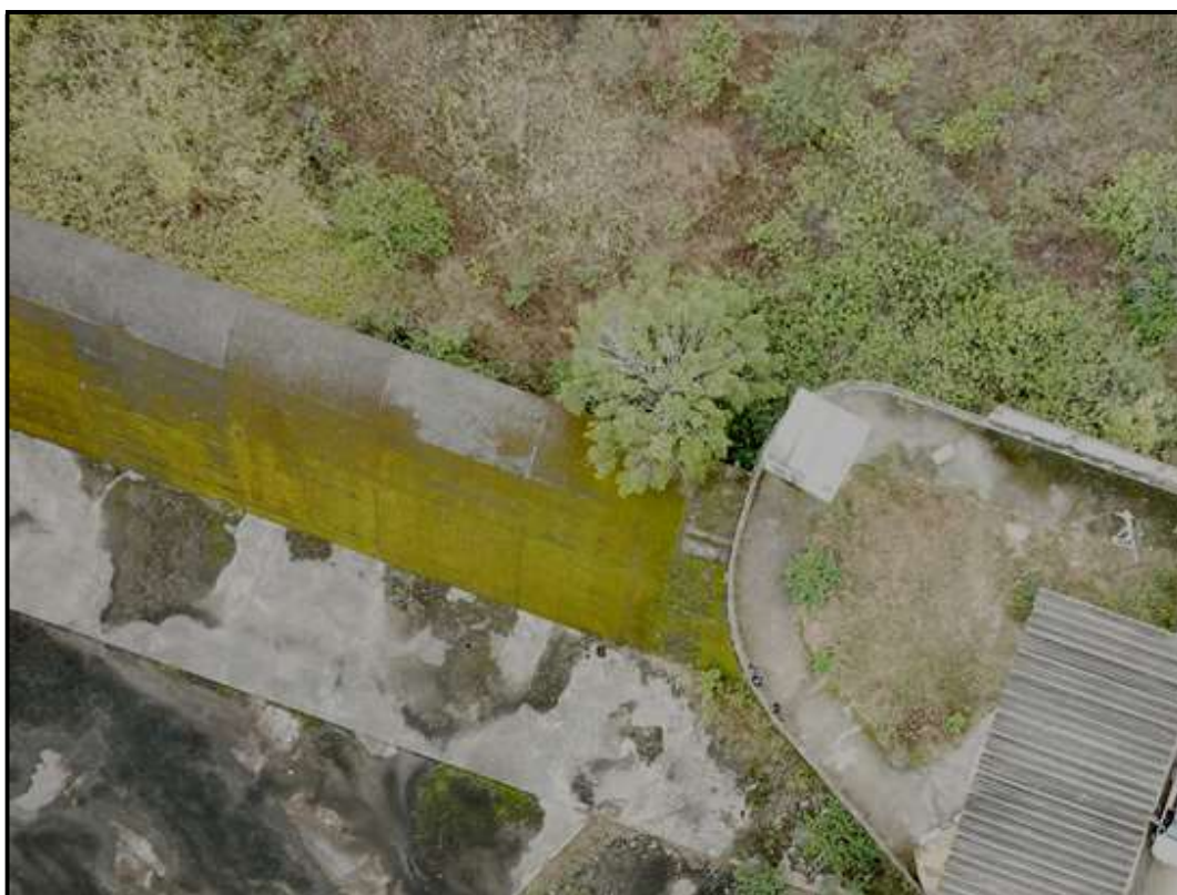
Foto 10 – Vista aérea da crista vertente mostrando presença de árvore excessivamente crescidas próxima à estrutura.
