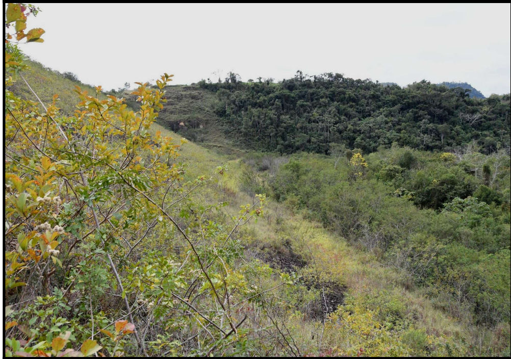
Foto 7 – Ombreira esquerda a jusante também com a presença de vegetação excessiva.
