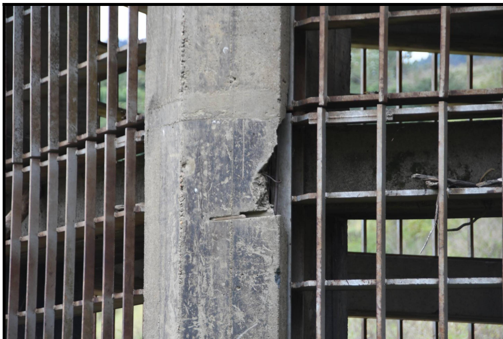
Foto 32 - Tulipa do Túnel interno face com falha de concretagem ou avaria devido a choque de tronco de árvore.
