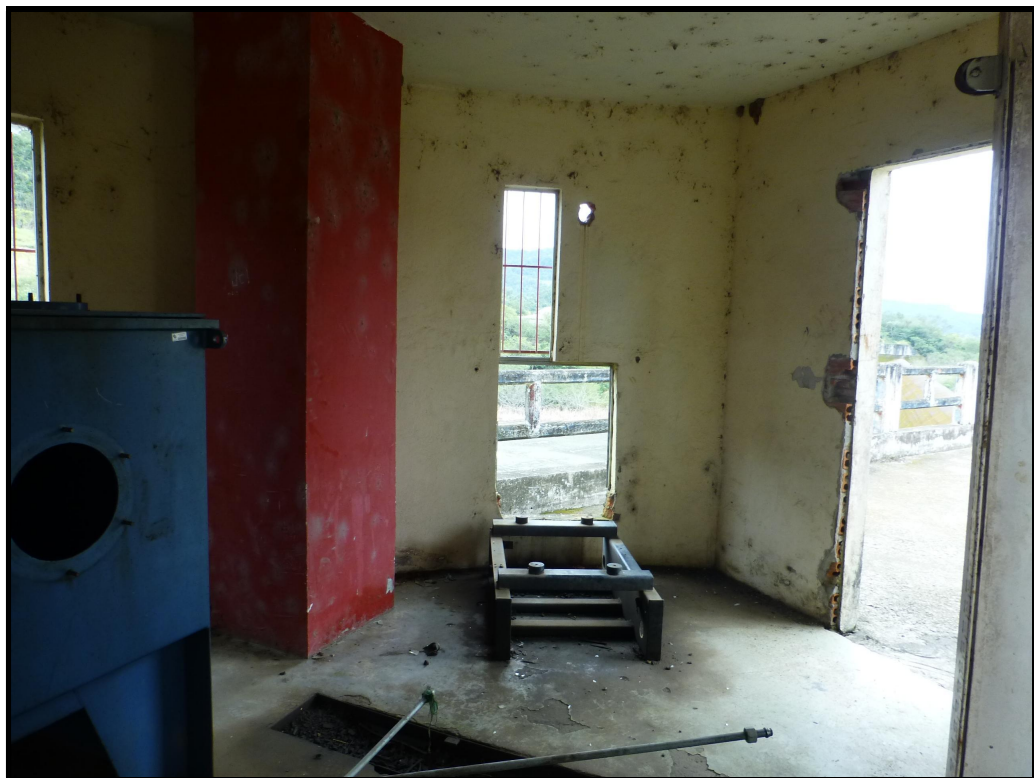
Foto 45 – Vista Interna da Edificação da Casa de Comando das Comportas, totalmente depredada
