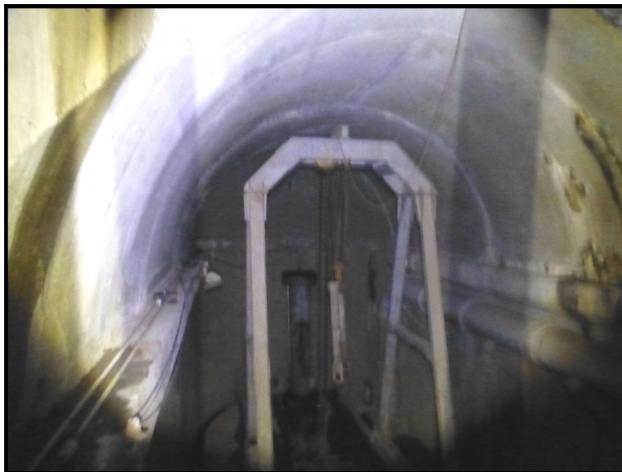
Foto 63 – Pórtico Móvel de Manutenção das Comportas de Controle de Vazão
