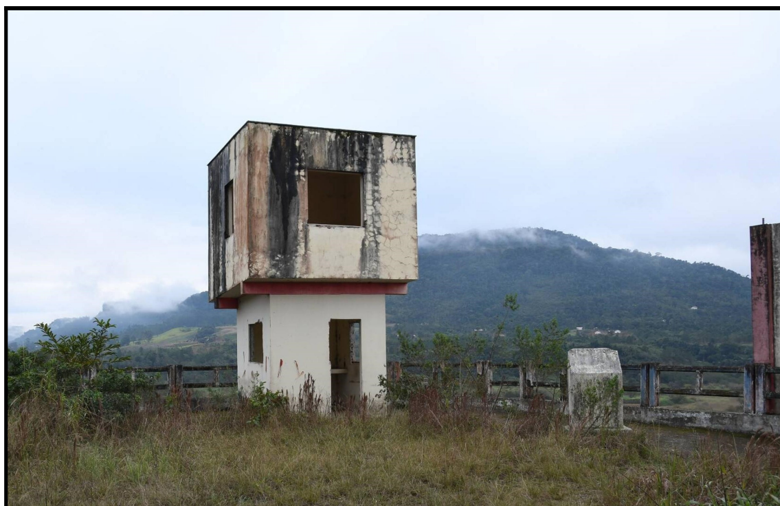
Foto 46 – Guarita de Segurança depredada e abandonada, sem porta e janelas.
