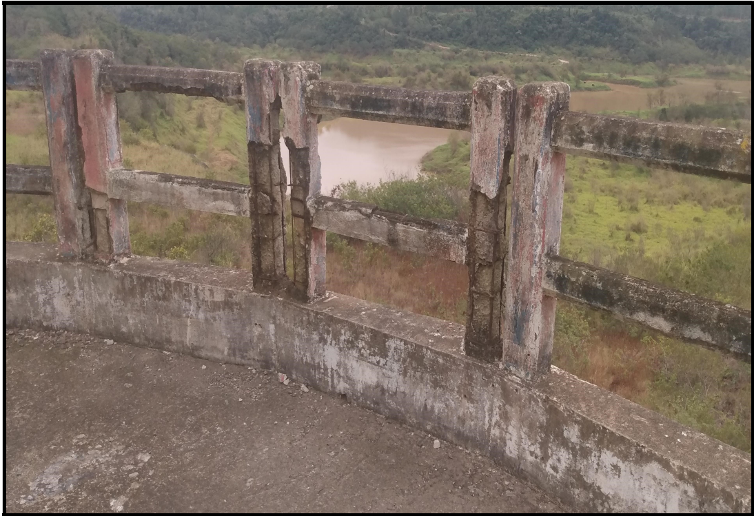
Foto 47 – Guarda corpo deteriorado da área da Plataforma de Operação das Comportas.
