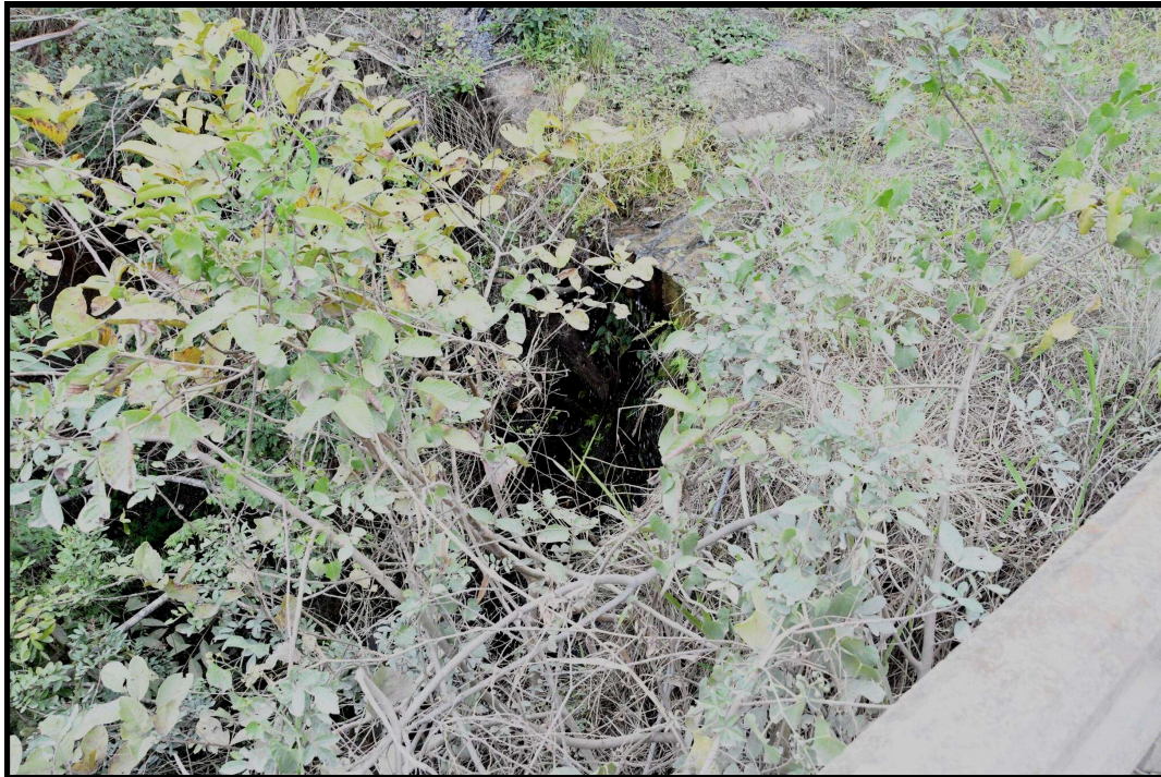
Foto 68 –Drenagem da estrada jogando água no talude próximo ao encontro direto da ponte sobre o Canal de Restituição.
