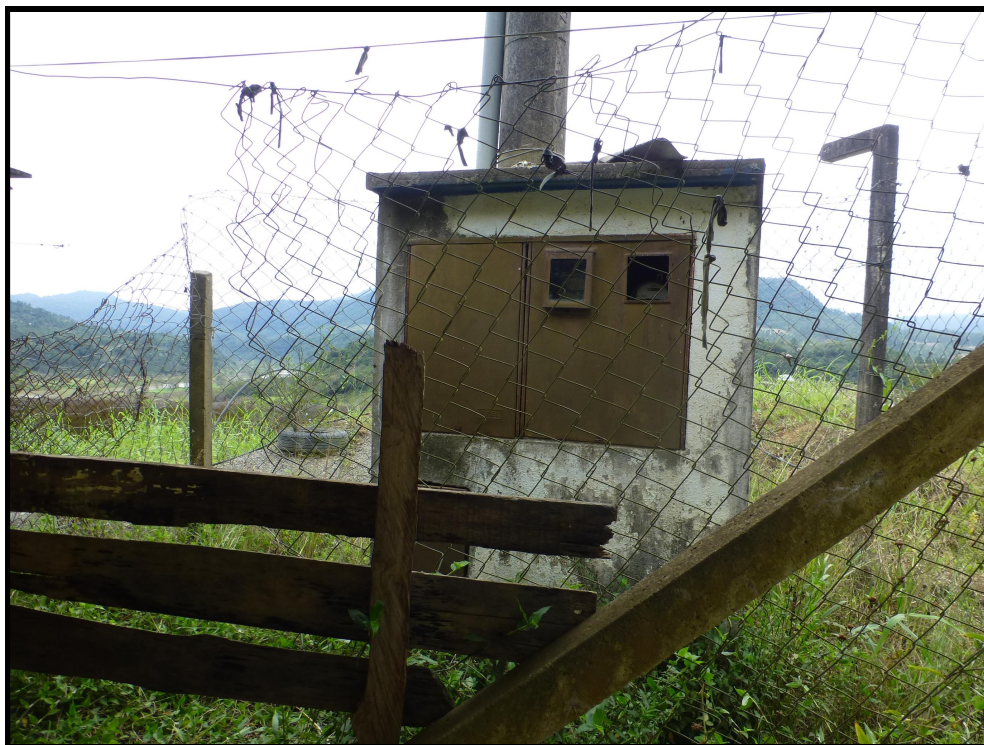
Foto 65 – Posto de Medição, Proteção e Seccionamento do Sistema de Alimentação Elétrica
