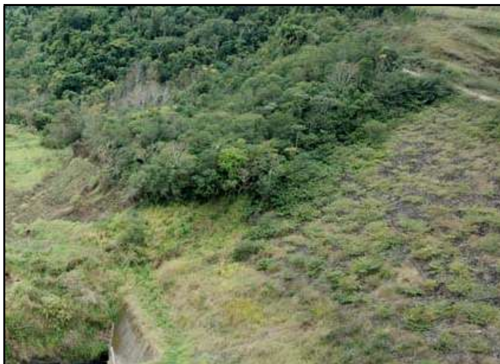
Foto 6 – Ombreira esquerda a montante, com presença de vegetação excessivamente alta.
