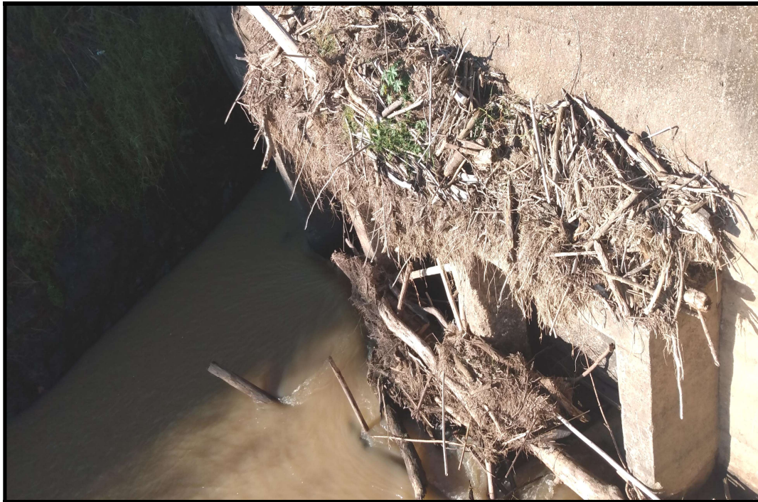
Foto 14 - Boca de Entrada da Galeria de Descarga com acúmulo de galhos e troncos
