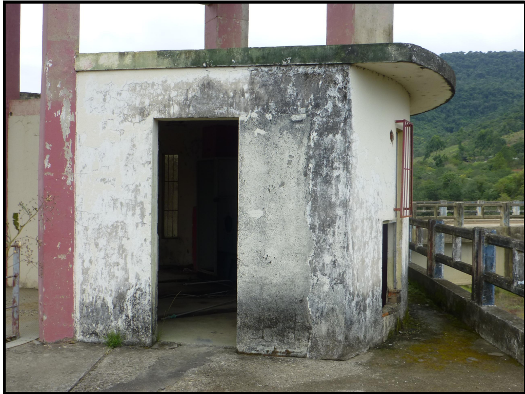
Foto 44 – Vista Externa da Edificação da Casa de Comando das Comportas, totalmente depredada
