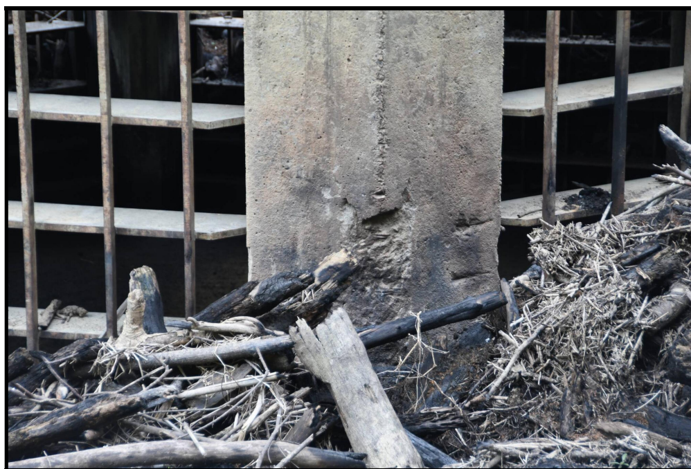
Foto 36 – Base da estrutura de emboque tipo tulipa (entrada do Túnel Externo) com sinais de queima do material lenhoso junto à estrutura.
