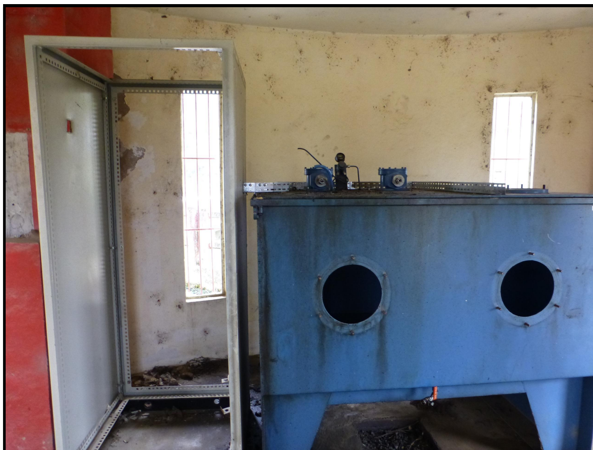
Foto 59 – Painel Elétrico de Proteção e Comando e Unidade Óleo-Hidráulica de Acionamento das Comportas Inutilizados.
