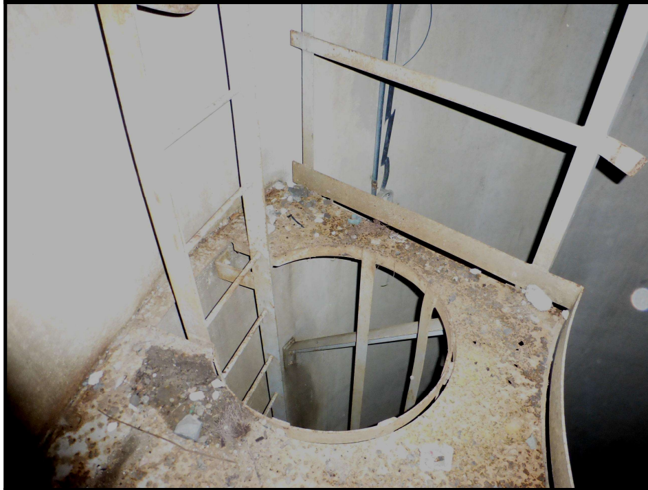
Foto 54 – Escada Tipo Marinheiro e Patamar de Descanso do poço de acesso à Galeria das Comportas, com problemas avançados de corrosão.
