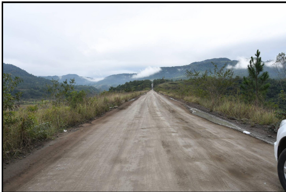
Foto 3 - Vista geral da crista com presença de pequenos buracos e problemas de drenagem
