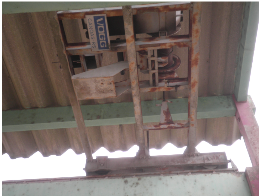
Fotos 58 – Ausência das roldanas, do gancho, cabo de aço e gancho da elevação.
