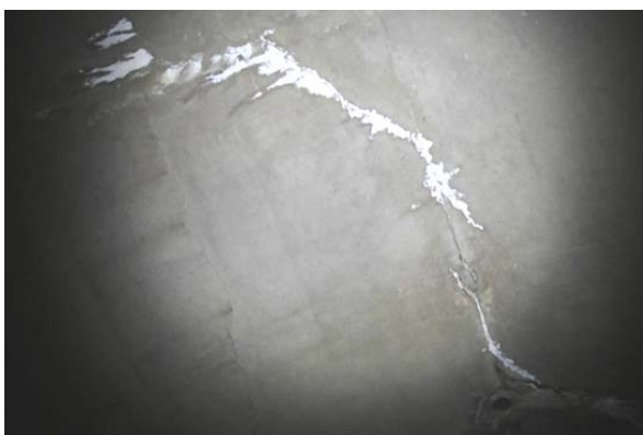
Foto 21 – Túnel Interno – 3ª fissura contada de montante para jusante no trecho livre
