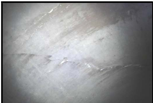
Foto 19 – Túnel Interno – 1ª fissura contada de montante para jusante no trecho livre.
