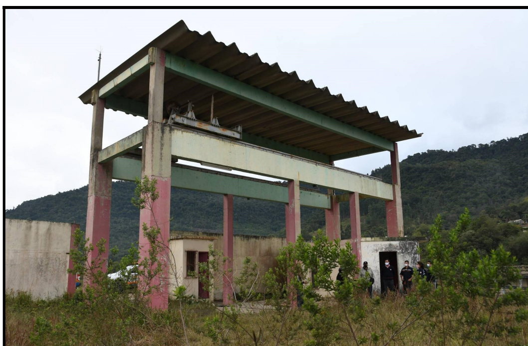
Foto 43 – Area externa da Casa de Comando totalmente depredada e sem portão.
