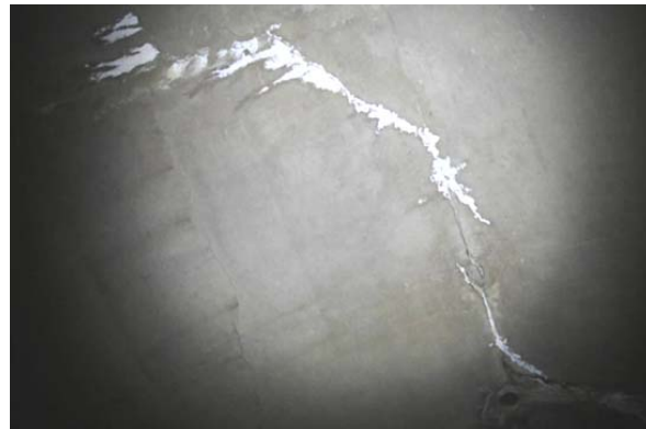
Foto 20 – Túnel Interno – 2ª fissura contada de montante para jusante no trecho livre.
