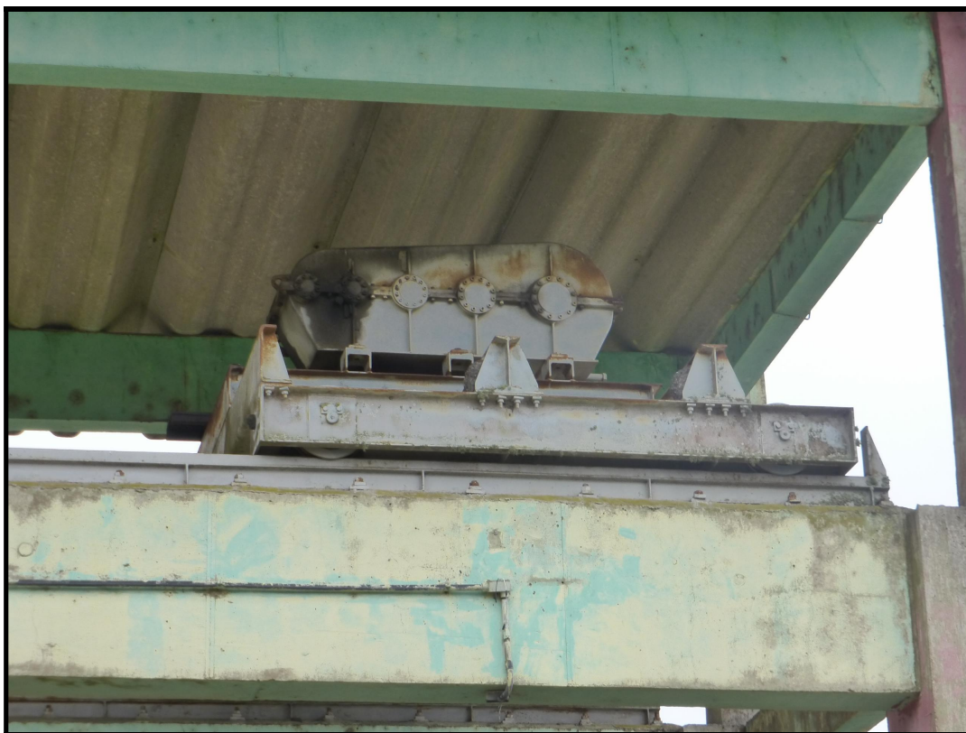
Foto 56 – Ponte Rolante de Manutenção das Comportas.
