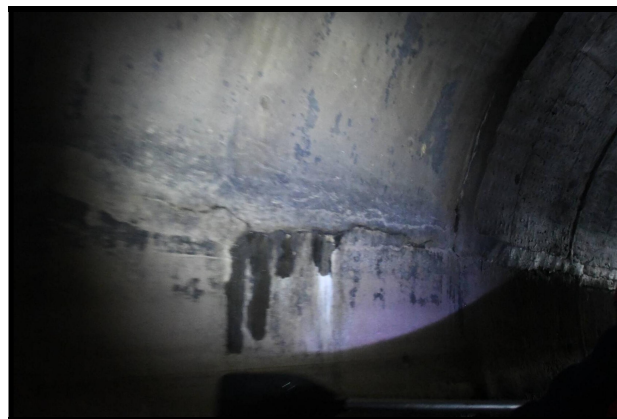
Foto 28 – Fissura com percolação de água no trecho livre do túnel externo.
