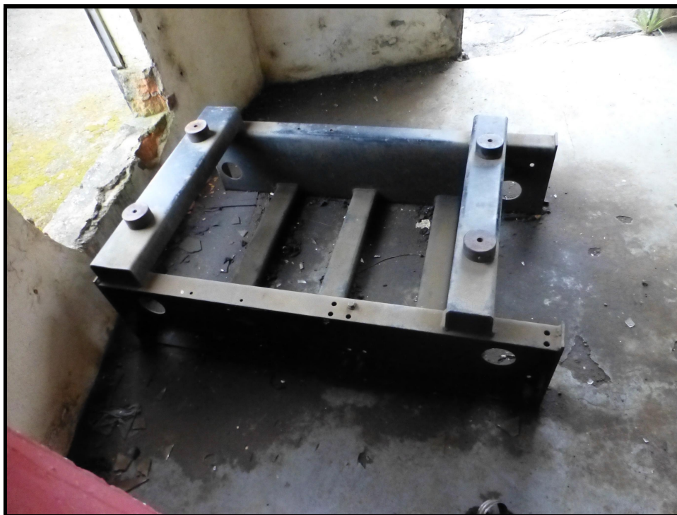
Foto 66 – “Skid” do Grupo Gerador Diesel-Elétrico do Sistema de Alimentação Emergencial de Energia Elétrica da Plataforma de Operação das Comportas.
