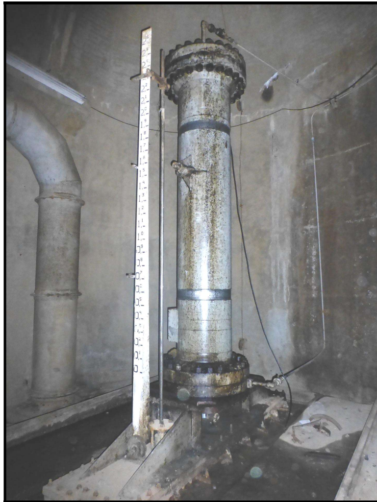
Foto 62 – Servomotor da Acionamento das Comportas.
