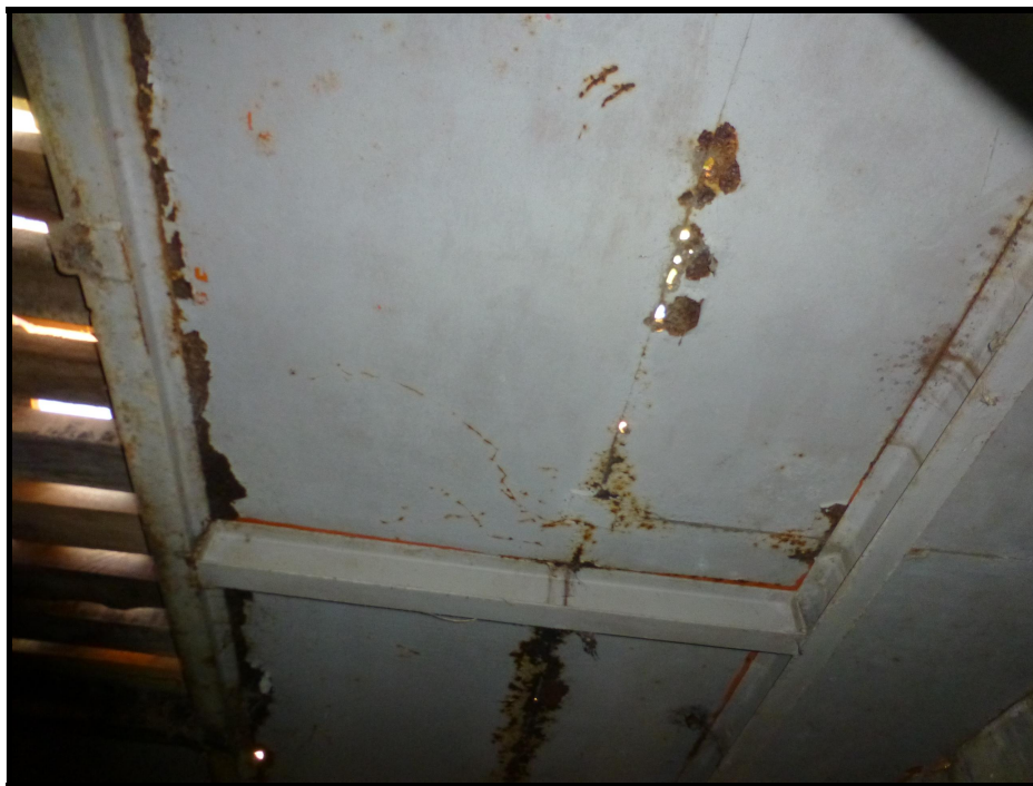
Foto 53 – Tampa Metálica do poço de acesso à Galeria das Comportas com problemas de corrosão decorrente de falta da manutenção.
