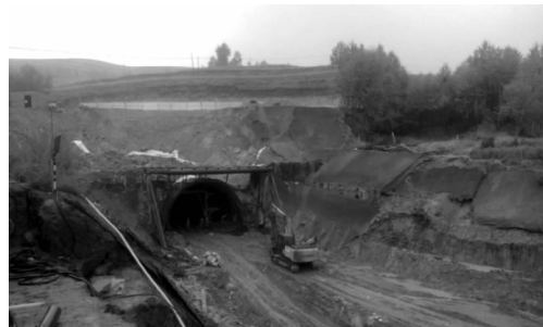
图 2 隧道工程造成地形、地貌破坏
