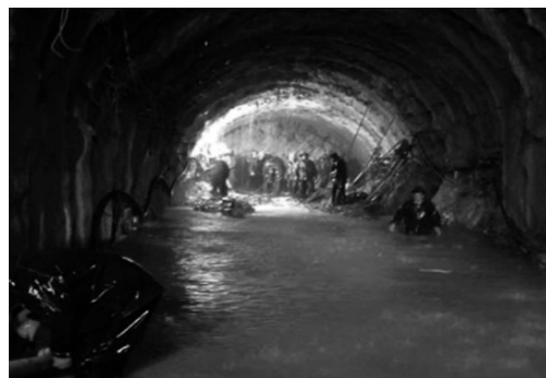
图 3 隧道施工造成的超排地下水
