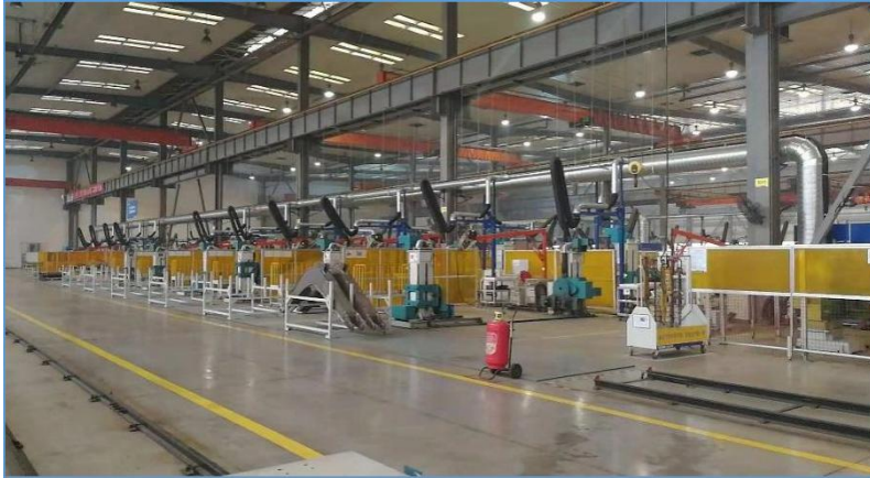
图 4 焊烟除尘设备
