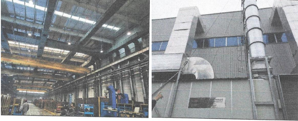
旅顺基地焊接厂房整体除尘系统
